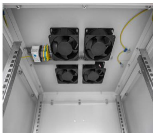
Widok z zainstalowanymi wentylatorami
