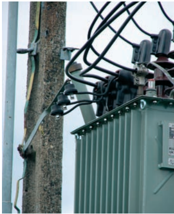
początek linii napowietrznej nn
