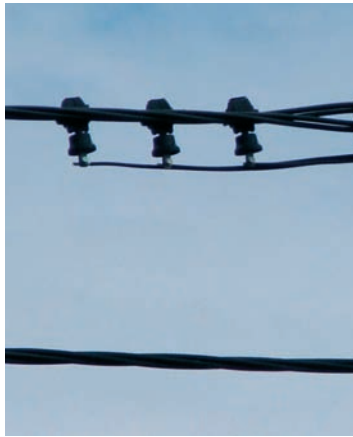
linia główna 1 komplet ASA co 500 m
