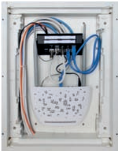
Rys. 1. Rozdzielnicę MSF Multimedialna
