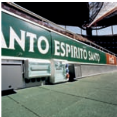
Fot. 1. Obudowa rozdzielcza Kaedra na stadionie w Lisbonie
